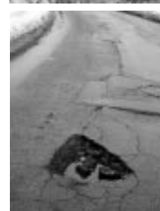
U góry: SM „Podgórze” radziła sobie wynajmując firmę z minipługiem, który – np. przy ul. Włoskiej na Woli Duchackiej – zgarniał śnieg nie tylko z ulicy, ale także z chodnika. Na dole: Dziura w jezdni na ul. Łużyckiej.
