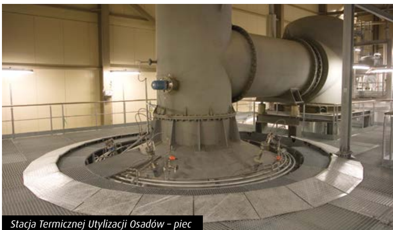
Stacja Termicznej Utylizacji Osadów – piec
